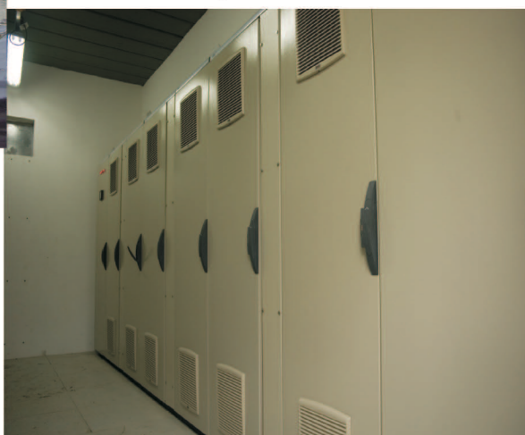
Sala de tableros, Planta totalmente Automática
