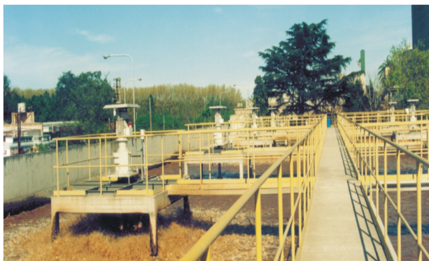
Cámara de Aireación
